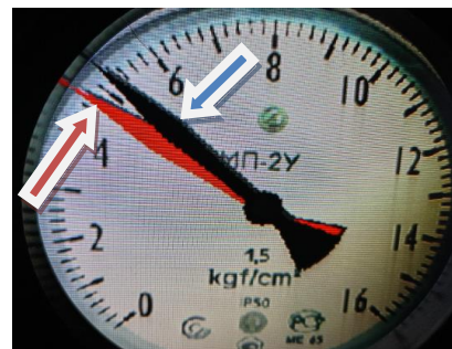
Нарушение производительности компрессоров
