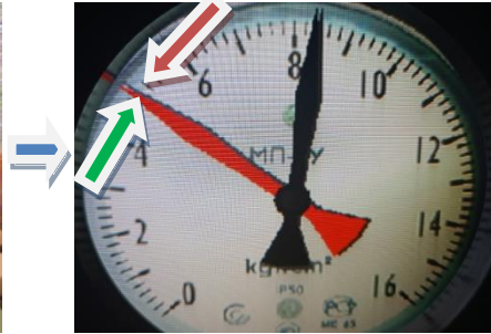
Отсутствие снижения давления по манометру ТМ
